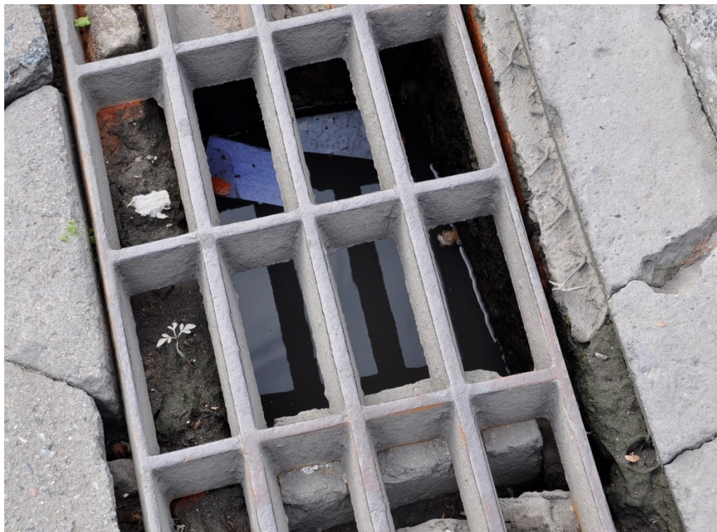
Foto 4 – Grelha existente com rede obstruída – Avenida Nereu Liberato Nunes.
